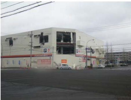
写真-31 外壁の落下
