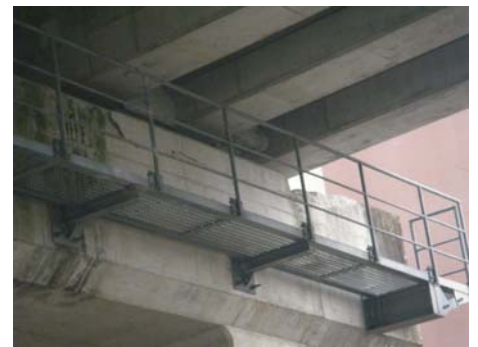
写真-18 橋座の損傷
