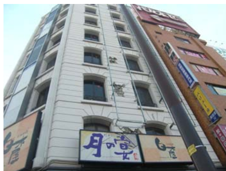
写真-5 外壁の損傷
