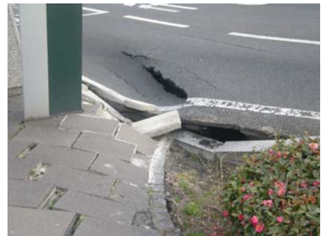
写真-3 路面の沈下
