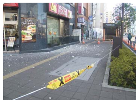
写真-6 外壁の損傷
