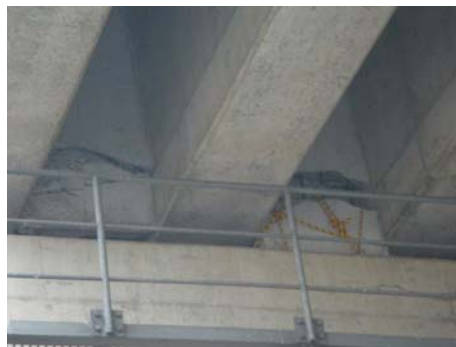
写真-18 横桁の損傷
