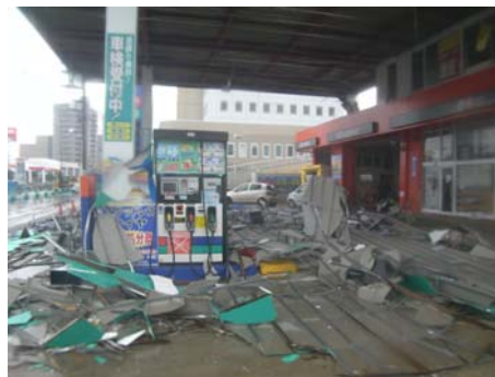
写真-32 天井の落下
