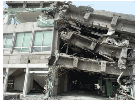
(d) 建物崩壊箇所西側の様子 (南→北)
