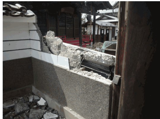
(b) 正面南側の壁（鉄筋あり）の崩壊 (東→西)
