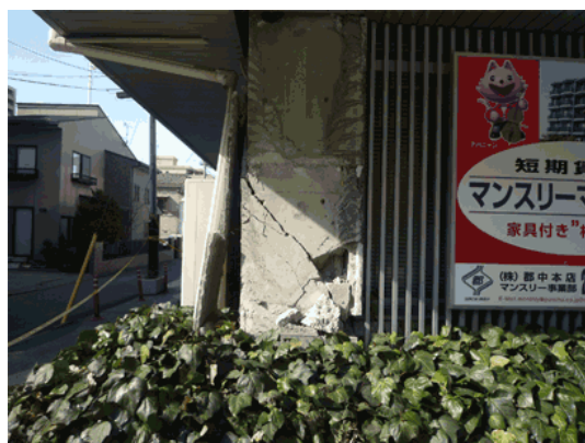
(d) RC 建物（1階部分柱の外装材剥落と柱損傷） (南→北)
