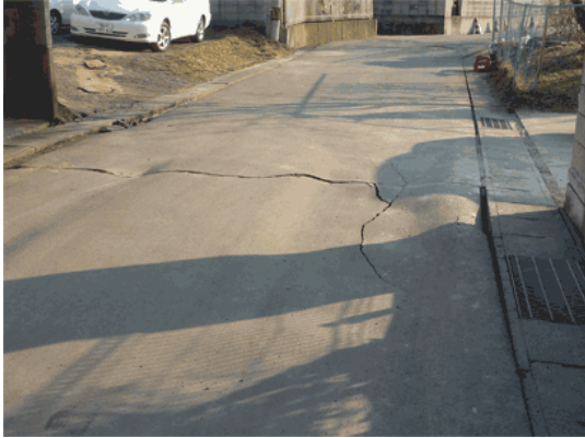
(g) アスファルトの大きなクラック (北東→南西)
