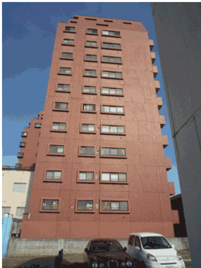
(h) RC 建物（斜めひび割れ） （西→東）
