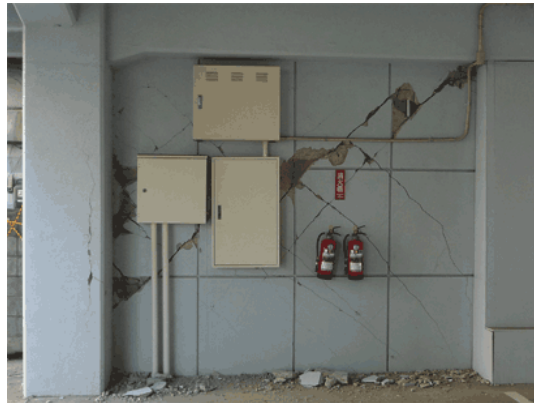
(h) RC 建物 1 階駐車場（せん断破壊） （北→南）
