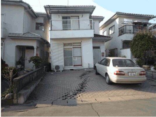
(m1) 住宅の傾斜 (その1) (南東→北西)
