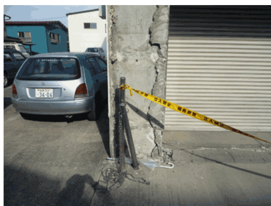
(e) RC 建物 北西側の1階柱（外装材の剥落） (西→東)
