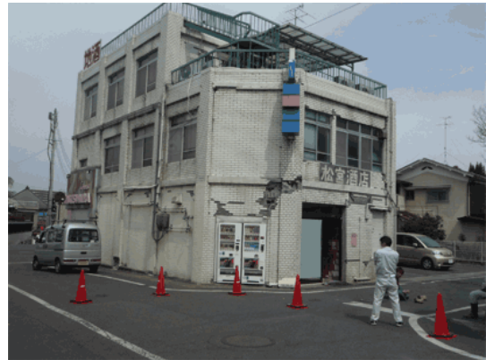
(d) 市役所北側の RC 建物の損傷 （南西→北東）
