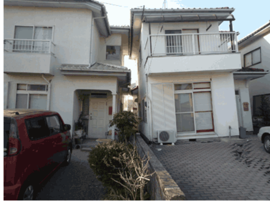
(m2) 住宅の傾斜 (その2) (南東→北西)
