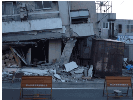
(d) 北側柱の破壊状態 (東→西)
