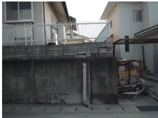
(y) 東西路地沿いの住宅傾斜・移動 (北東→南西)
