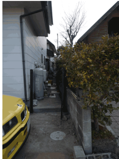
(G) 南北路地（東側）の住宅傾斜 （南東→北西）
