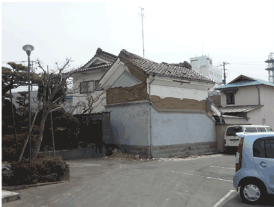
(a) 石川街道南側の土蔵壁の剥離 （北西→南東）
