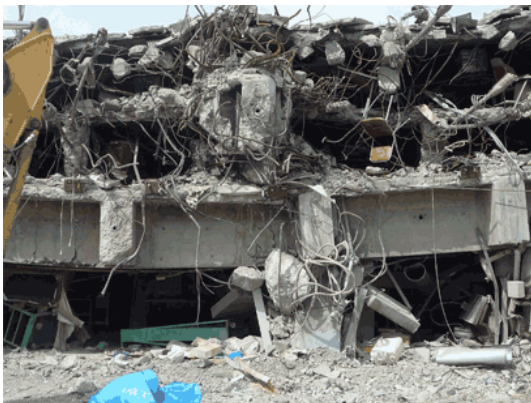
(e) 建物崩壊箇所中央位置の様子 (南→北)
