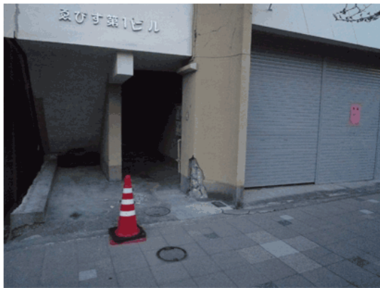
(h) RC 建物の柱基部かぶり剥落 (東→西)
