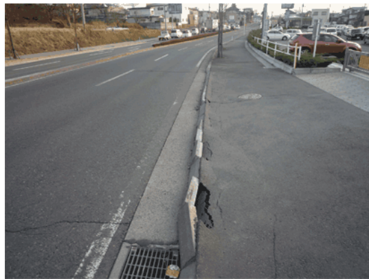
(R) 道路西側歩道の変形・隆起 (北→南)
