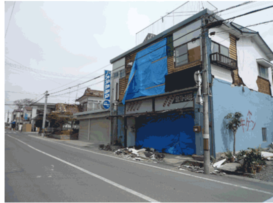
(d) 木造住宅の壁剥落 (南西→北東)
