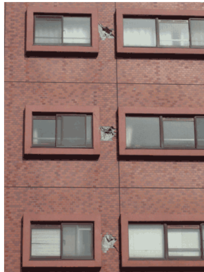
(i) RC 建物（斜めひび割れ） （西→東）
