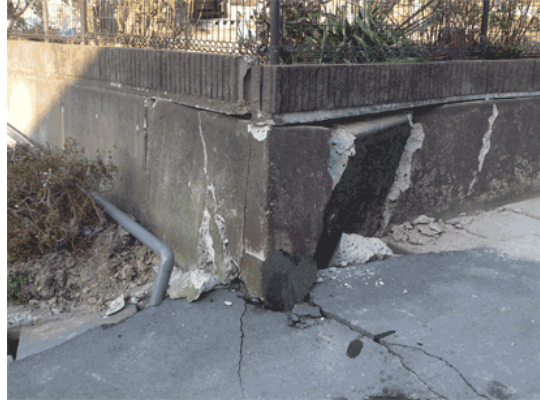
(h) 擁壁とアスファルトの衝突 (西→東)
