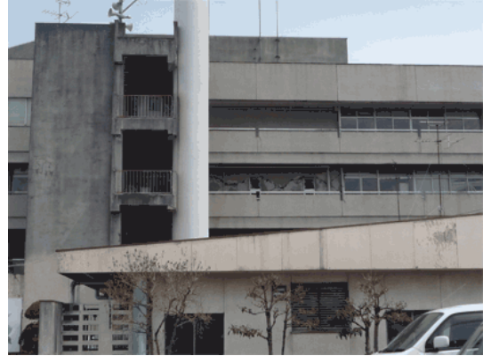
(b) 同左建物西側：RC 壁のせん断破壊 （西→東）
