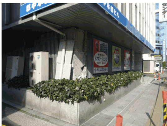
(c) RC 建物（1階部分柱の損傷） (西→東)
