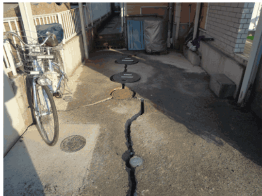
(t2) タンク浮き上がり （北西→南東）
