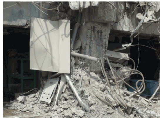
(f) 建物崩壊箇所西側柱の損傷状態 (南→北)
