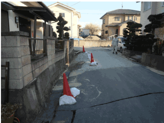
(k) アスファルト隆起と塀の移動 (北西→南東)
