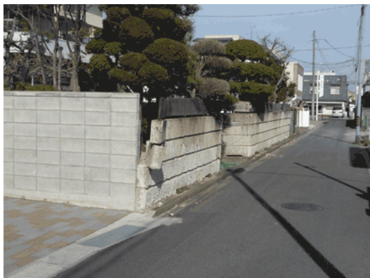
(a) 虎丸周辺住宅のブロック塀の損傷 (西→東)
