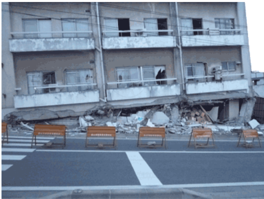
(c) 1 階部分が圧潰 (東→西)
