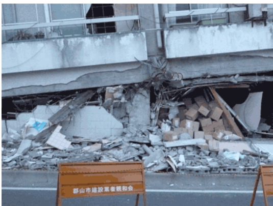
(e) 中央柱の破壊状態 (東→西)
