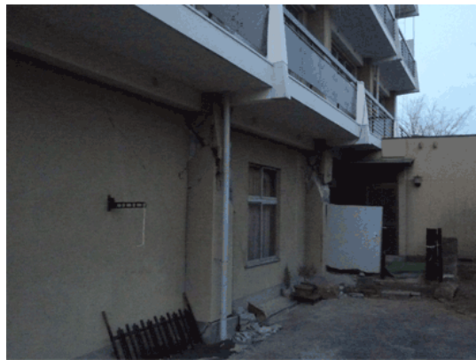
(i) 南側1階柱のせん断破壊 (西→東)
