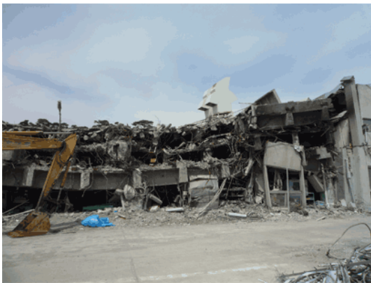
(c) 建物崩壊箇所東側の様子 (南→北)
