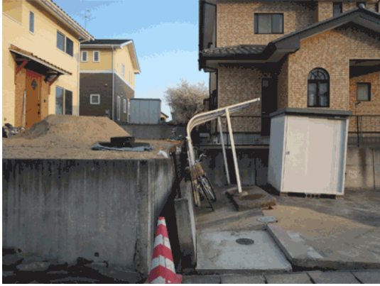
(z) タンクの浮き上がりと移動 (北西→南東)
