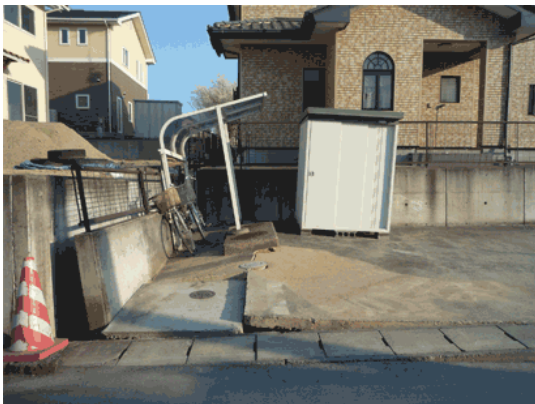
(n1) タンク浮き上がり (その1) (北西→南東)
