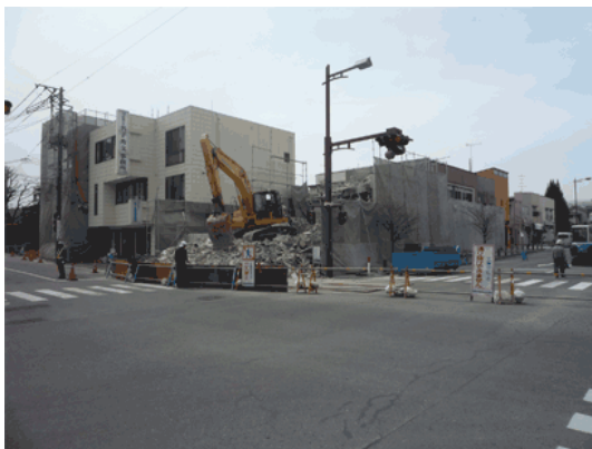
(a) 石川街道南側沿いの3階RC建物の崩壊 (北東→南西)
